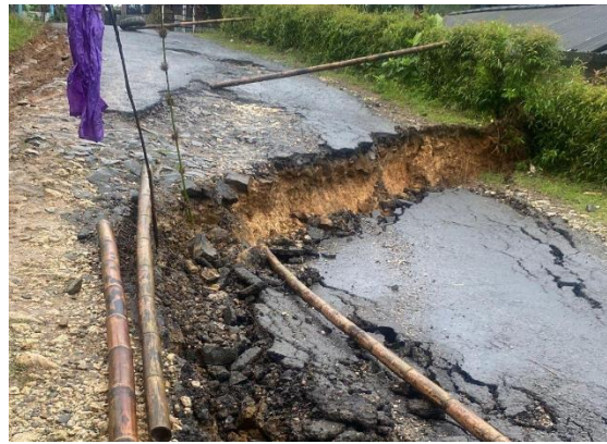
Gambar 2. Kondisi tanah longsor pada Kecamatan Tulakan (29 Juni 2023)
