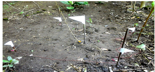
Gbr. 9 Foto Pengukuran Resistans Pentanahan 1 Batang Pentanah dengan Elektrode Sangkar Persegi 4 Batang Penyusun
