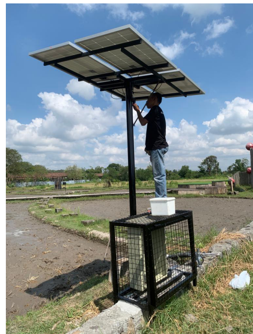
Gambar 2. Pemasangan Panel Surya untuk pengairan hidroponik akuaponik yang terletak di persawahan Dusun Pengklik, Desa Madurejo. Sumber: Data penulis, 2022
