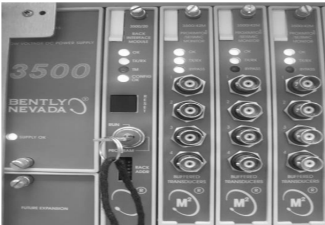
Gambar 7. Bently Nevada 3500 pada turbin unit-2
