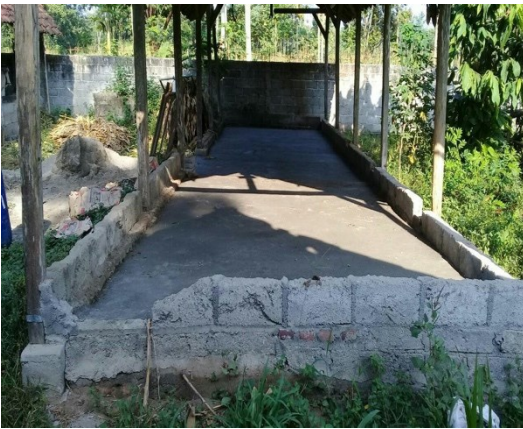
Gambar 5. Kondisi lantai kandang setelah diperbaiki
