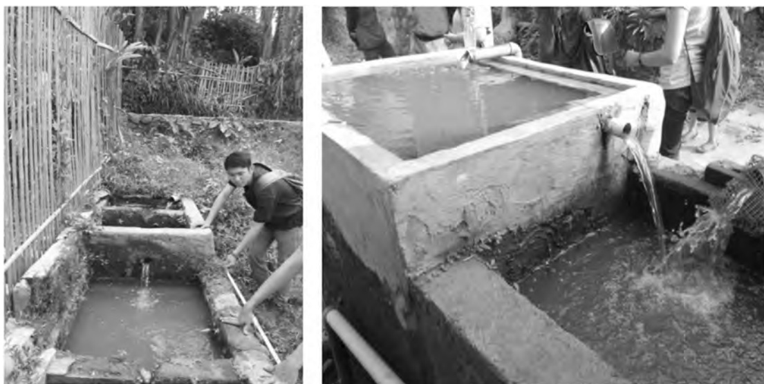
Gambar 1 Bak-Bak Sedimentasi yang Digunakan untuk Mengendapkan Pengotor Air dari Sungai
