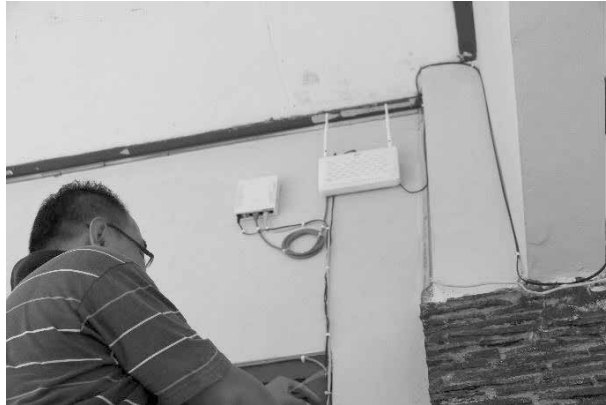
Gambar 7a Pemasangan Perangkat modem ZTE dan RB951Ui-2HnD
