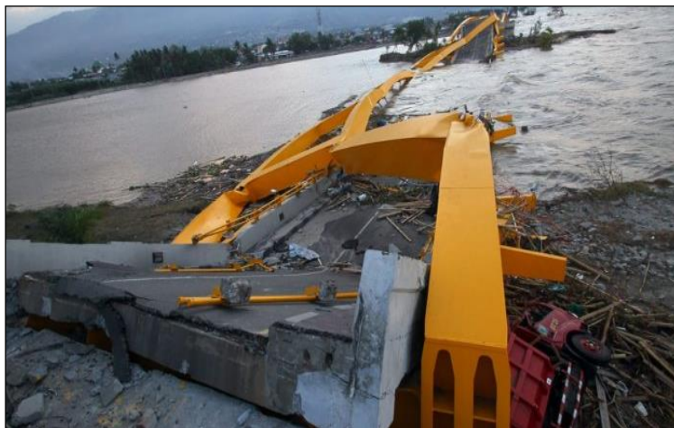
Gambar 3.2 Jembatan Ponulele yang roboh di Teluk Palu (Foto diambil dari arah timur menghadap ke barat).
